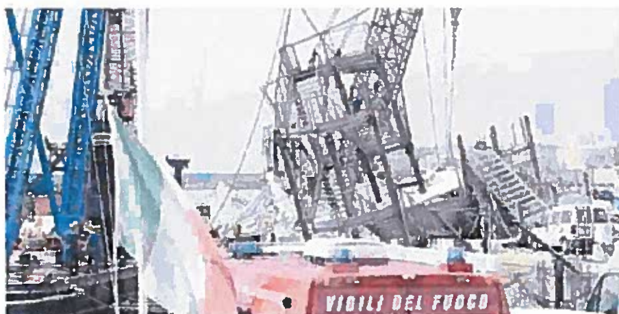
Macerie e rottami della Torre piloti dopo l'incidente del maggio 2013
